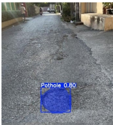
ภาพที่ 5: ตัวอย่างการใช้โมเดลในการตรวจจับหลุม
